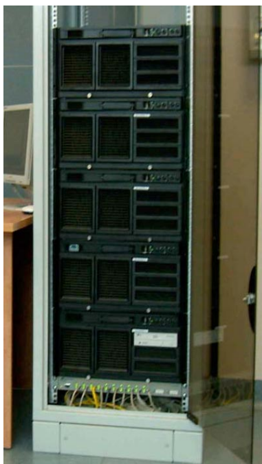
Widok klastra znajdującego się na Wydziale Elektrycznym PB
