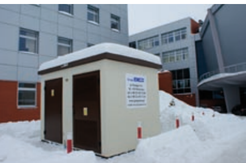
Stacja typu BEK 250/370 zainstalowana na terenie Politechniki Białostockiej
