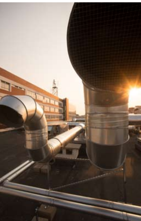
System wentylacyjny Wydziału Budownictwa i Inżynierii Środowiska
