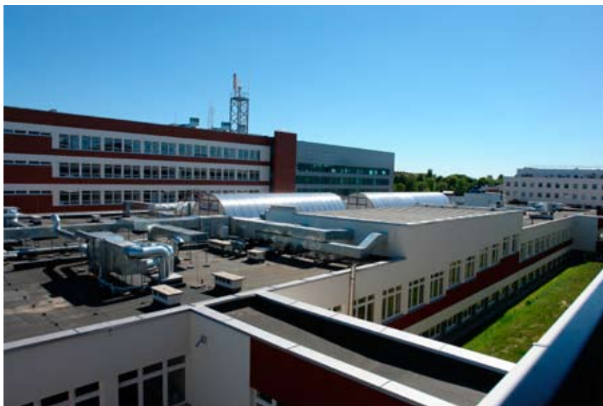
System wentylacyjny Wydziału Budownictwa i Inżynierii Środowiska
