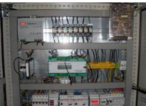
Widok szafy sterowniczej MEW w m. Grunajki, fot. K. Żukowski
