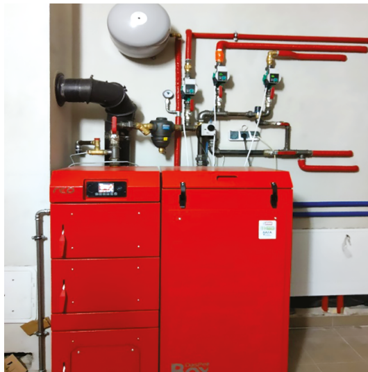
RYS. 15. Instalacja CO wykorzystująca piec na pellet
