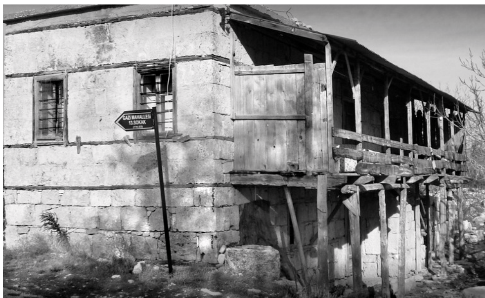
Ryc. 29. Dom z tufu wulkanicznego, wzmacniany drewnianymi listwami hatıl ; źródło: Wikimedia Commons ( https://commons.wikimedia.org/wiki/File:Bir_ev_uzunca_burç_-_panoramio.jpg , na licencji CC-BY 3.0, fot. Haluk Comertel, 2008)
